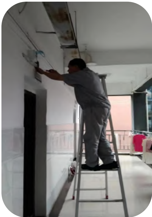
宿舍楼电源故障检查
